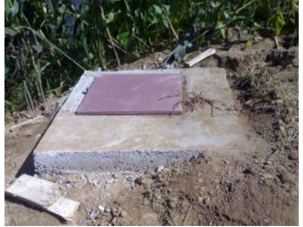
İçmesuyu Vana Rogarı
