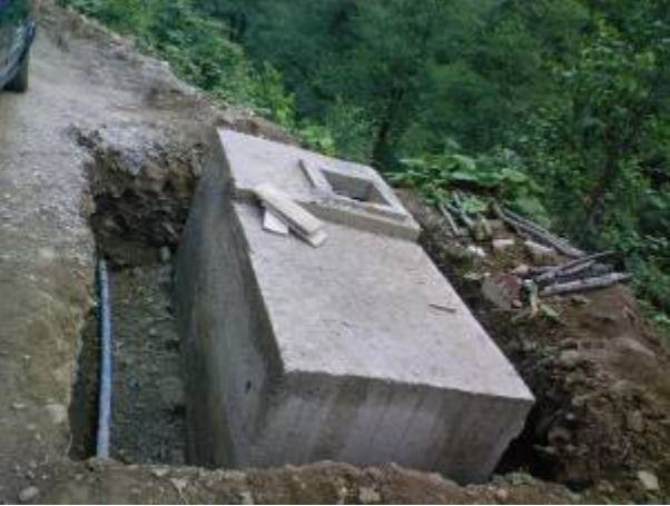
İçmesuyu Tesisi Su Toplama Odası
