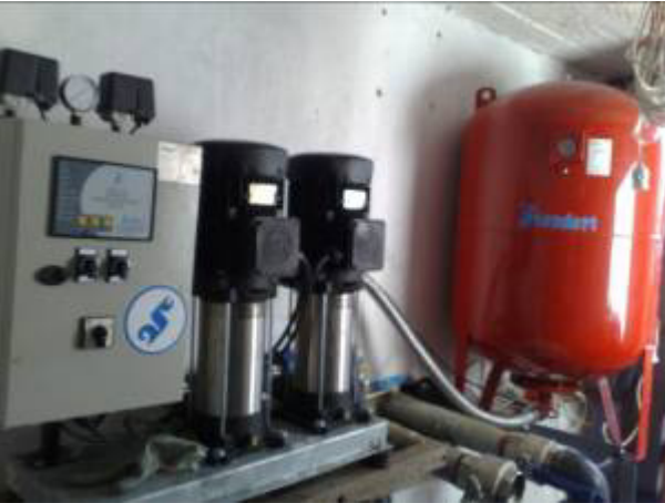
İçmesuyu Hidrofor Tesisi
